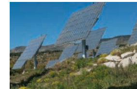
Subsol Konzentrator- Photovoltaikanlage
