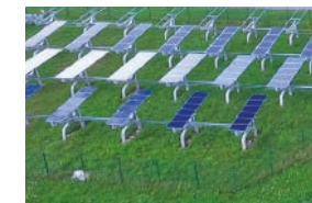
EDF Renewables Centrale solaire photovoltaïque sur trackers
